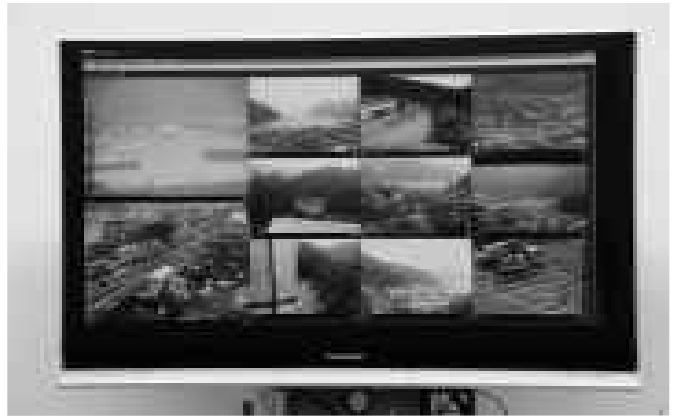
防災情報システム（無線LANシステム）
